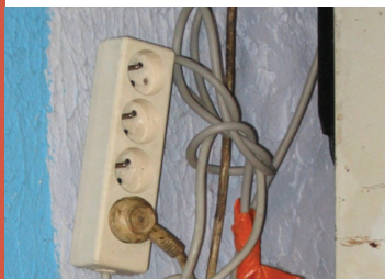
Installation électrique dangereuse
