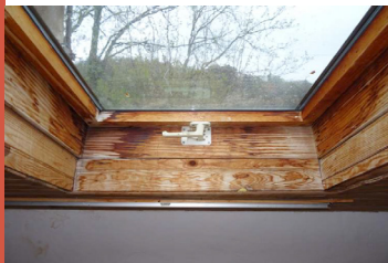
Absence de protection contre les infiltrations d'eau
