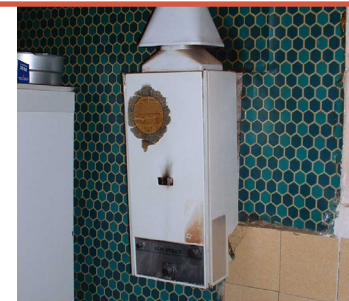
Absence de dispositif d'évacuation des gaz brûlés
