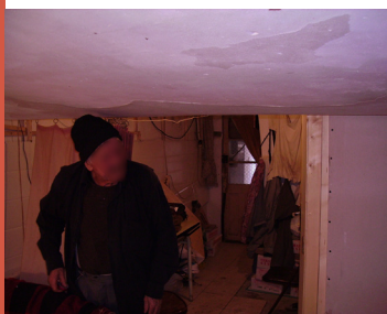
Hauteur sous plafond insuffisante
