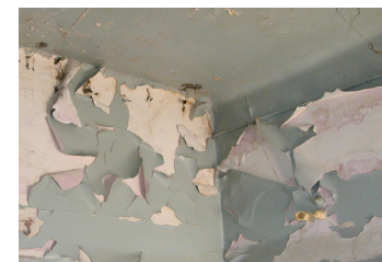
Peinture écaillée contenant du plomb
