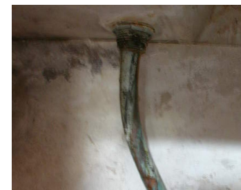
Absence de siphon
