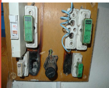
Branchements d'électricité vétustes
