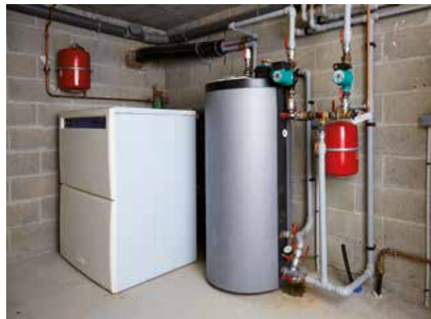
Une pompe à chaleur géothermique est généralement associée à un ballon tampon qui stocke l'eau chaude pour la distribuer au bon moment dans le réseau de chauffage.
